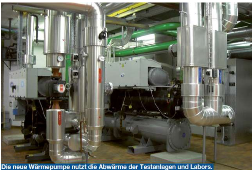
Die neue Wärmepumpe nutzt die Abwärme der Testanlagen und Labors.
