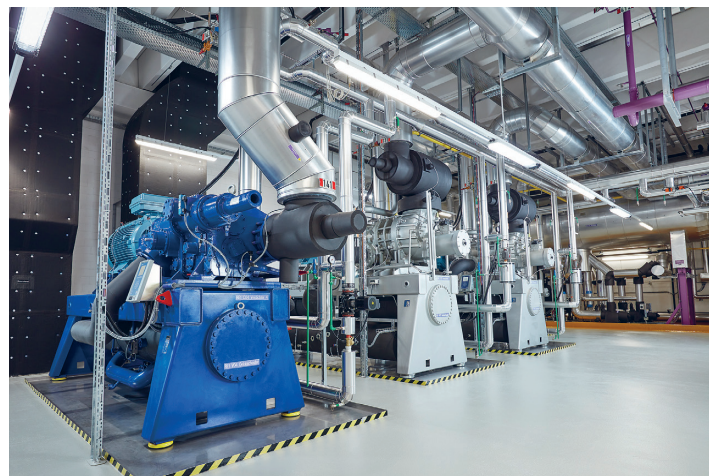
Abbildung 3: Ammoniak-Kälteanlage für die Industrie
