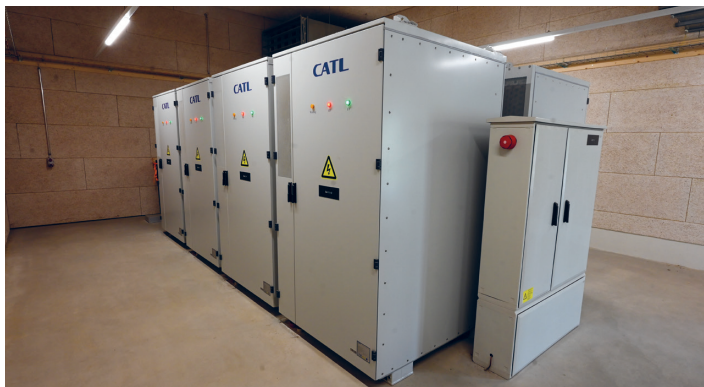
Abbildung 2: Der Grossbatteriespeicher mit einer Leistung von 2,5 MW stellt Primär- und Sekundärregelleistung bereit.
